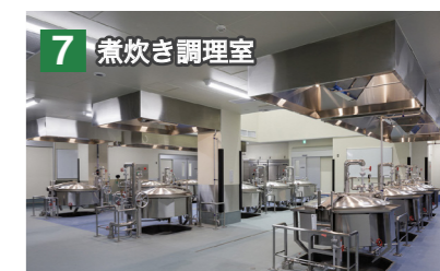
7 煮炊き調理室 煮炊き釜は床に水がこぼれにくいエプロン付き。釜側面は調理中も熱くない低放射構造で作業性、安全性に優れています。
