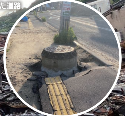
隆起したマンホール
