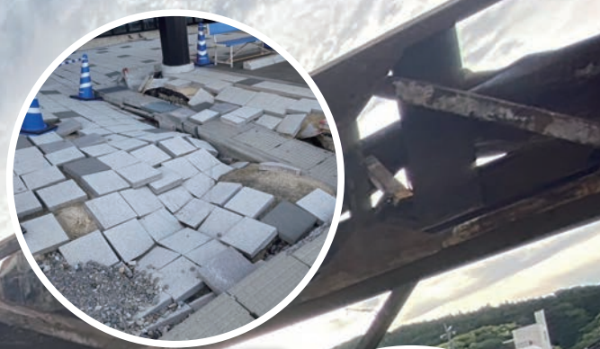
ガタガタになった道路
