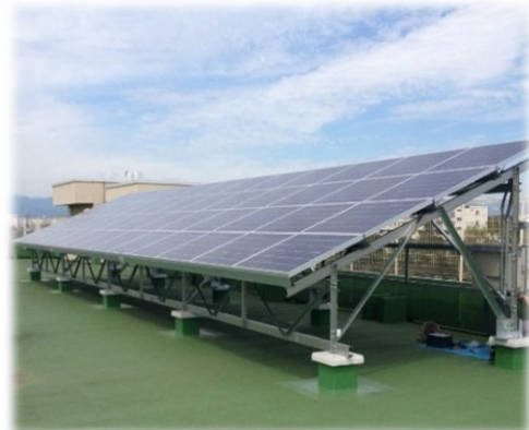
太陽光発電設備
