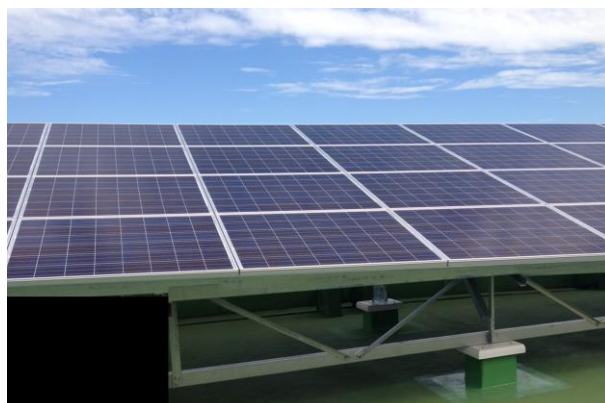
太陽光発電設備（市立雷塚小学校屋上）
