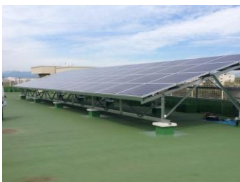
市立雷塚小学校屋上の太陽光発電設備
